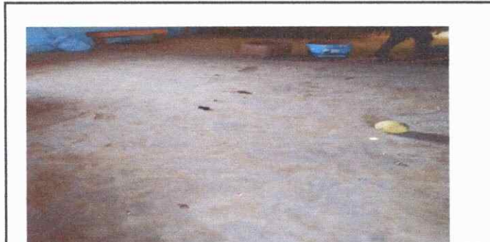
Foto 5: Se observa el deterioro del piso en el modulo I
