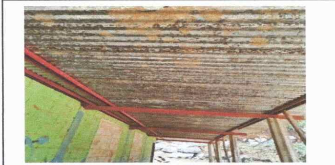
Foto 3: Se observa el deterioro del techo del módulo I
